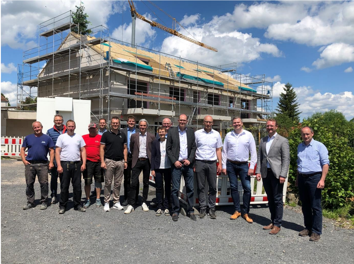
Bild: Vertreter der Kommunalpolitik, der Handwerksfirmen und der Planungsbüros machten sich gemeinsam mit den Bauherren ein Bild über den aktuellen Baufortschritt.
